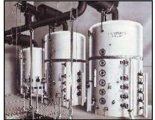
Vakuová stanice - dodávka fy Wiesner z roku 1914
